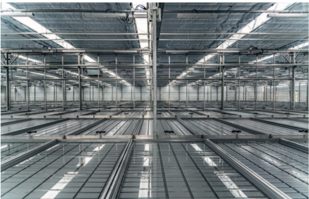
Für den perfekten Salat: In dem Gewächshaus werden Temperatur, Bewässerung und Lichteinfall vollautomatisch gesteuert
