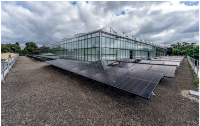
Ergänzt wird das nachhaltige Konzept durch Photovoltaik auf dem Dach
